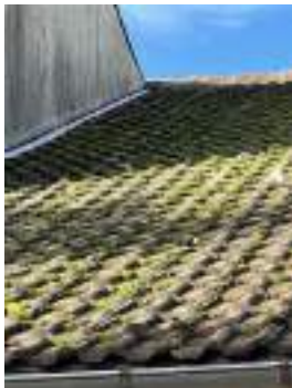
Présence de mousse sur la couverture
