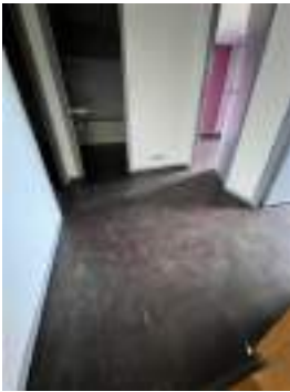
Présence de matériaux contenant de l'amiante
