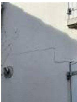
Microfissure sur crépi extérieur
