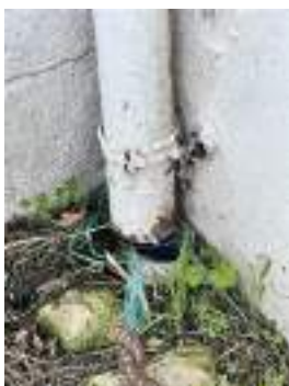
Descente d'eau pluviale (DEP) non raccordée Rejet des eaux de toiture non canalisé, provoquant des désordres sur les façades, les fondations et les aménagements périphériques.
