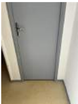
Détalonnage de porte non présent ou insuffisant
