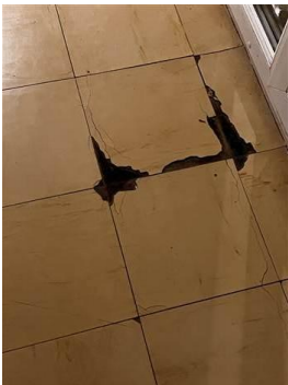
Présence d'amiante dans le bâtiment
