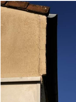
Microfissure sur crépi extérieur
