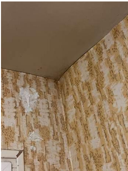
Moisissure et champignons au plafond sous comble perdu
