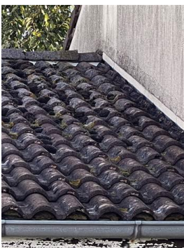
Présence de mousse sur la couverture
