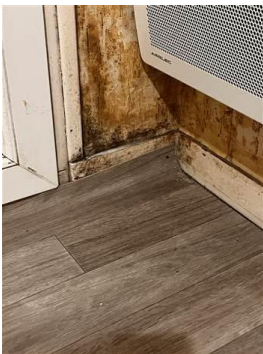
Moisissure noire sur mur intérieur
